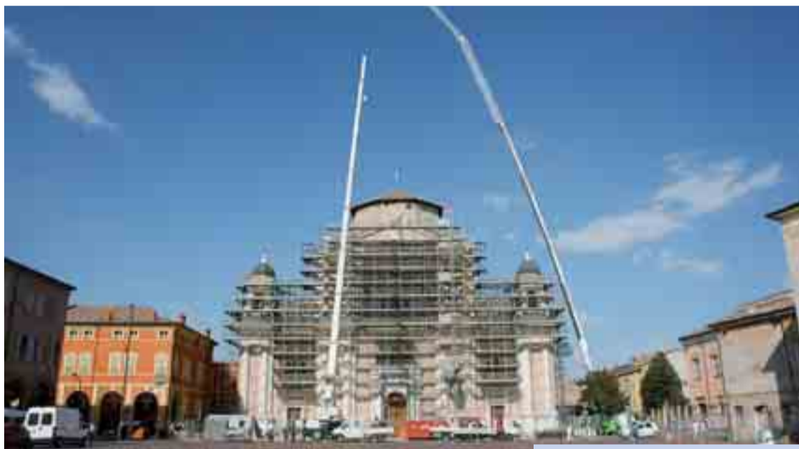
La Cattedrale di Carpi danneggiata dal sisma
