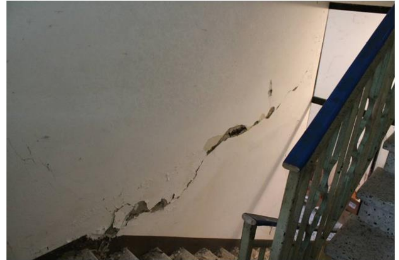
Piano primo vano scala sud – lesione su parete
