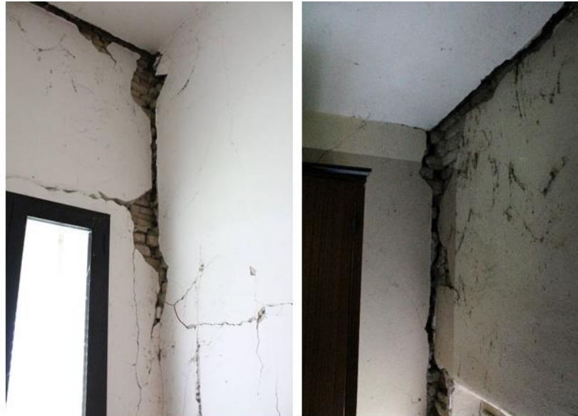
Piano terzo e vano scala sud – lesione tra parete esterna, soffitto e ed altra parete portante
