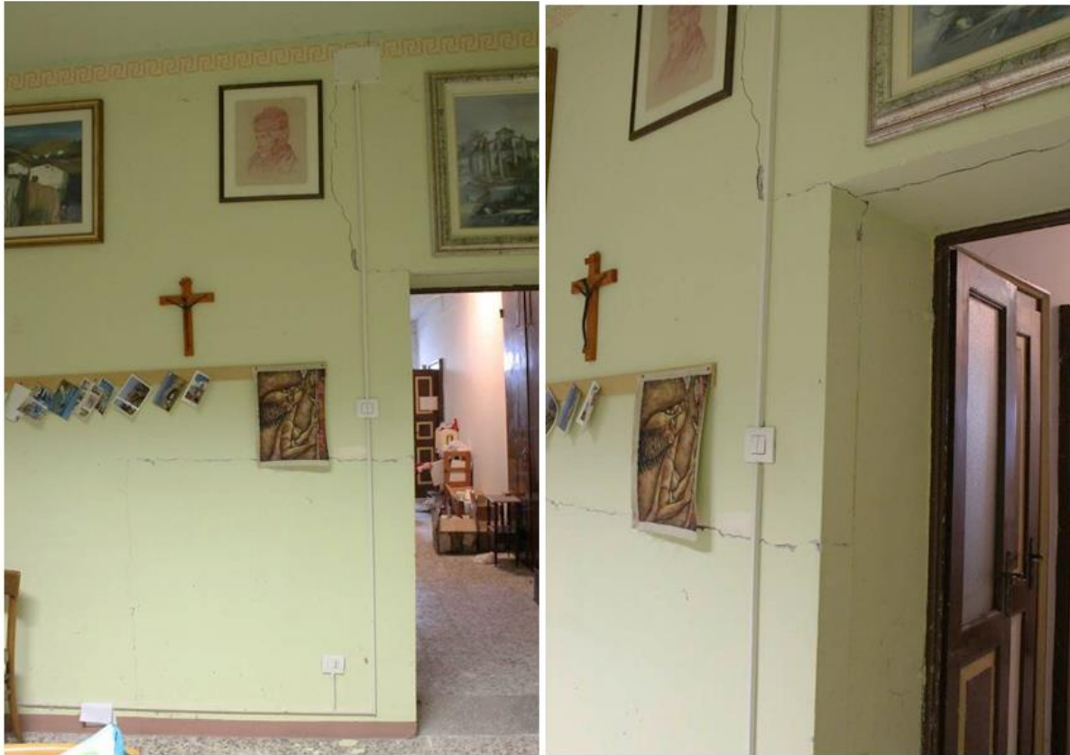
Piano terra – lesione su parete portante interna in corrispondenza di apertura
