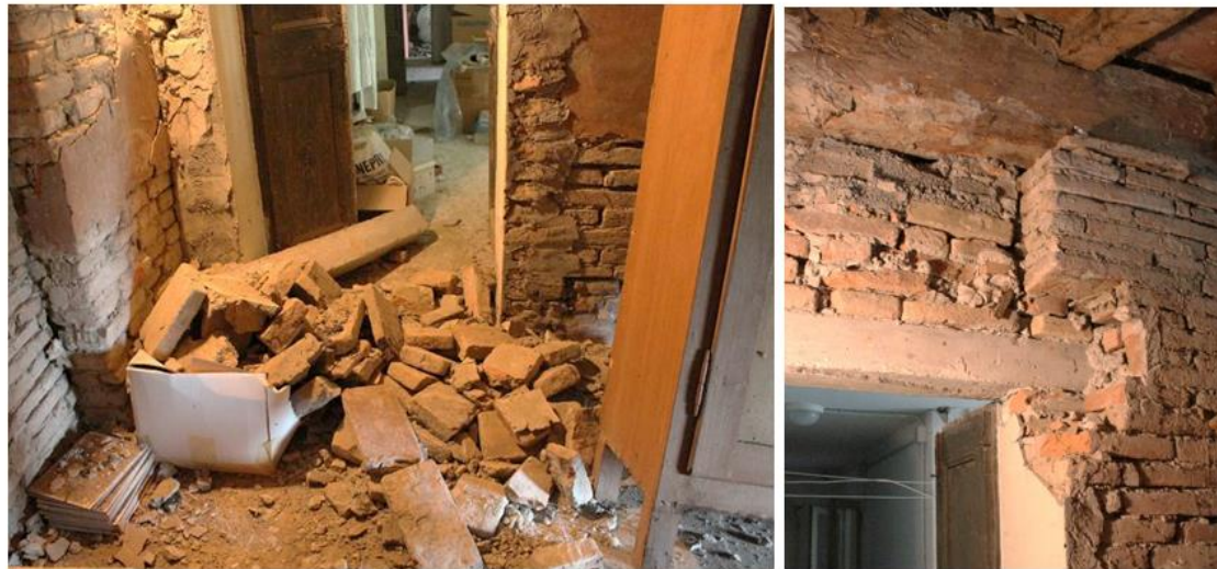
Piano terzo (sottotetto) – crollo di architrave e di controparete non ammassata
