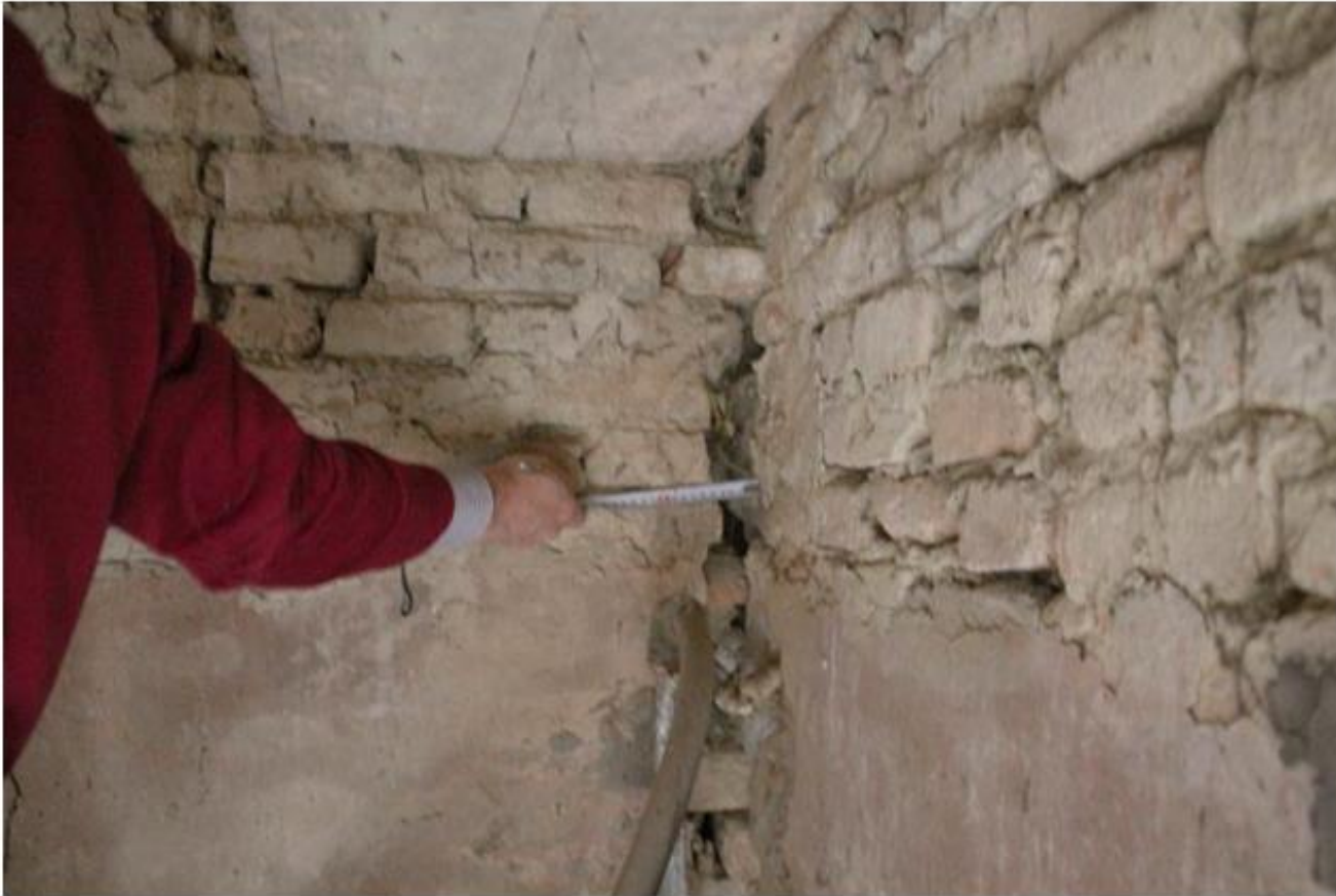
Piano terzo (sottotetto) – lesione tra parete esterna e ed altra parete portante
