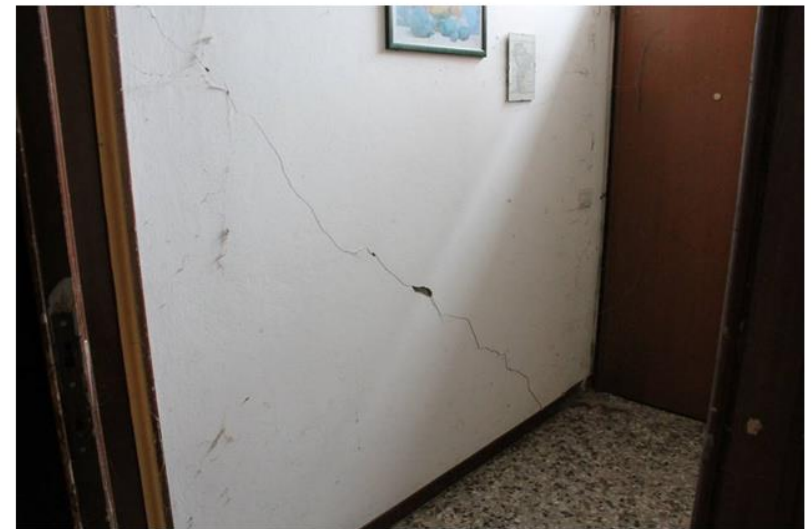
Piano terra – lesione su parete portante perpendicolare alla parete esterna ovest
