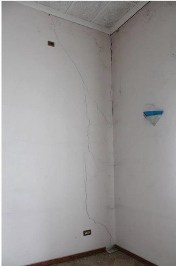
Piano primo teatrino – lesione su parete trasversale a ridosso della parete esterna ovest
