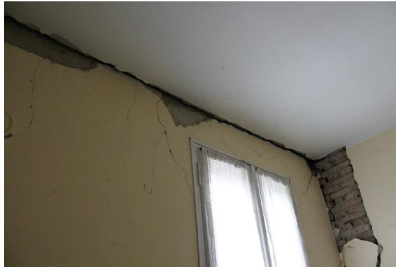
Piano secondo – lesione tra parete esterna, solaio e parete trasversale
